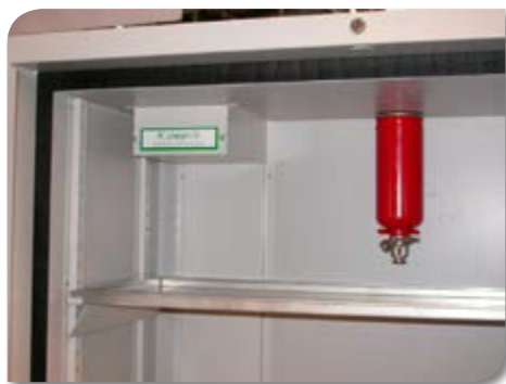
Extincteur installé dans une armoire de sécurité
